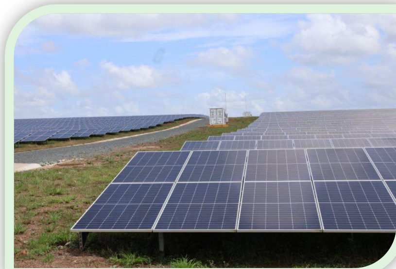
Parque Solar Martí
